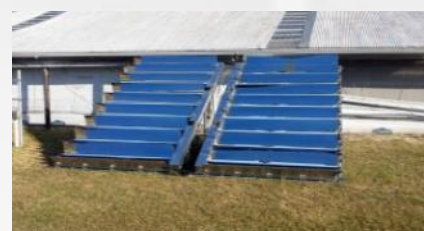
Solar CSP Array
